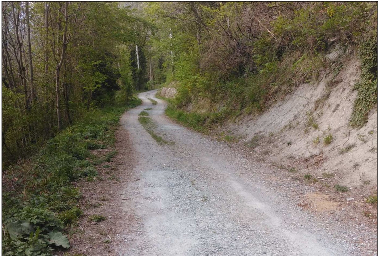
Fig. 1 – Tratto della strada sterrata esistente a valle della centrale “Verdettaz” esistente nel quale il canale del Borgo scorre già intubato e verrà posata la nuova tubazione in acciaio
