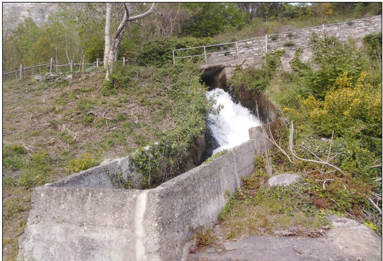
Fig. 2 – L’impluvio naturale munito di opere di regimazione idraulica mediante il quale dal canale della Pianura viene attualmente scaricata la portata di competenza del canale del Borgo
